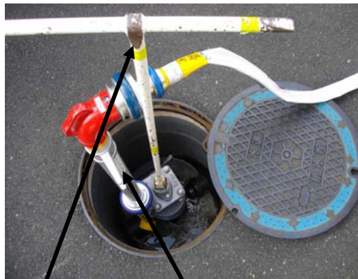
スタンドパイプ及び スピンドルドライバー（放水弁の開閉用）
